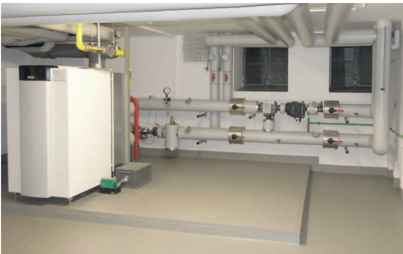
Nach der Sanierung: neue Heizungsanlage mit RENDAMAX 604. Auf Grund der fehlenden Bauhöhe wurde die Verrohrung waagerecht angeordnet. Während der gesamten Bauphase wurde der Heizbetrieb lediglich an zwei Tagen teilweise eingeschränkt.
