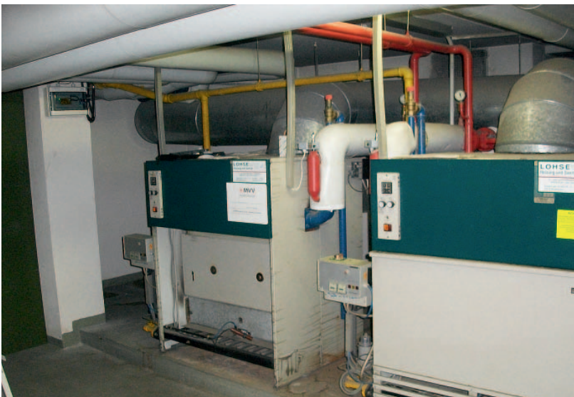
Die alte Heizungsanlage mit einem Niedertemperatur-Heizkessel entsprach nicht mehr dem Stand der Technik.
