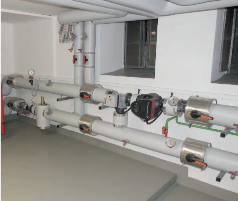
Heizungsanlagen benötigen Energie. Durch den Einsatz geregelter Pumpen können bis zu 80% Energiekosten eingespart werden.
